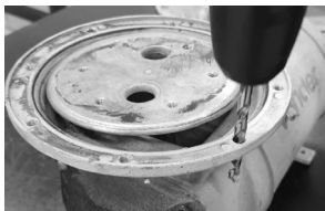
Fig. 1 – Limpieza de la rosca dañada
