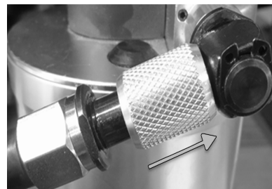
Fig. 12 – Válvula de paso de aire abierta
