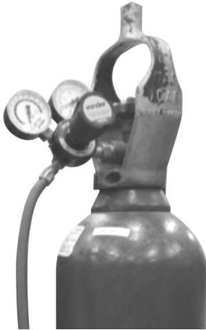
Fig. 3 – Instalación de gas
