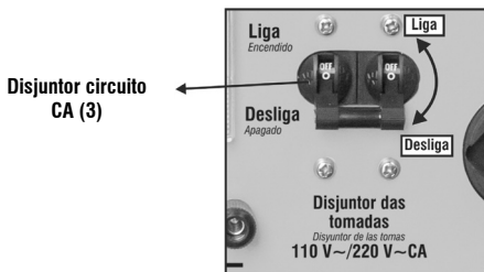
Fig. 16 – Disjuntor circuito CA
