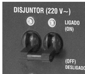
Figura 13 – Disjuntor do Circuito CA
