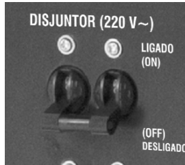
Figura 13 – Disyuntor del Circuito CA
